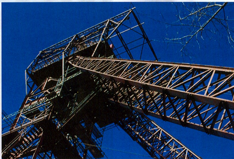
Ungewohnter Blickwinkel: 34 Meter hohes Fördergerüst über dem Delbrück-Schacht II (1908) im Saarbrücker Stadtteil Klarenthal.
