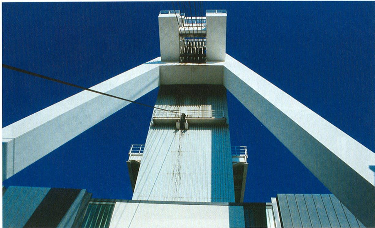
Das Fördergerüst des Nordschachtes in Falscheid bei Lebach zählt neben dem Schacht IV des inzwischen stillgelegten Bergwerks Göttelborn/Reden zu den jüngsten und imposantesten Industriebauten des Saarbergbaus.
